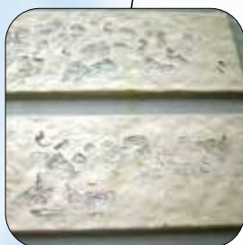
浮き・はがれ
